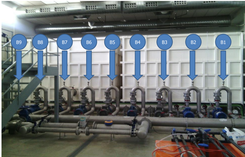
Ilustración: Foto de la estación de bombeo del Laboratorio de Hidráulica
